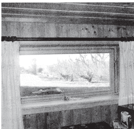
BOLIGHUS PÅ ORRE PÅ JÆREN: Hvis veggen her er isolert med mineralull helt inntil betongen, flyttes kondenspunktet fra betongen og inn til sjiktet mellom betong og isolasjon. I så fall blir det muggsoppvekst. Ofte finnes streptomyceter under slike forhold. Her må veggen åpnes for kontroll.
