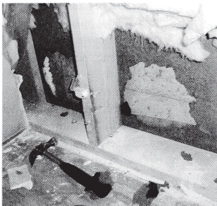
ENEBOLIG PÅ KARMØY: Isolasjonen har ligget helt inntil Asfaboard/betong. Pegasus Lab. AB fant høye konsentrasjoner av mikroorganismer, og analyseresultatet indikerer mikrobielle skader.
